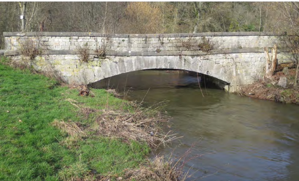
Pont voûte menaçant de s’effondrer à Beauraing.
